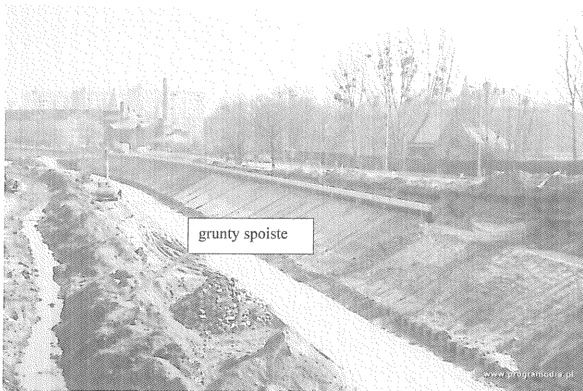
Zdj. 3. Lewy brzeg Kanału Miejskiego powyżej mostu Osobowickiego. Usunięte denne grunty spoiste i przegłębione dno dające kontakt wody z kanału z warstwą przepuszczalnych pospółek. Na skarpie widoczna przeciwdziałająca filtracji poprzednia warstwa gruntów spoistych
